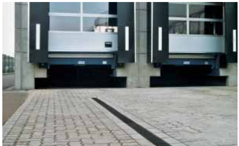
ACO DRAIN® Multiline® til overfladeafvanding ved et center for logistik.
